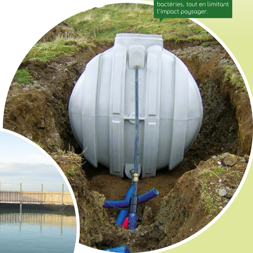
Impluvium ou bassin de stockage des eaux pluviales
